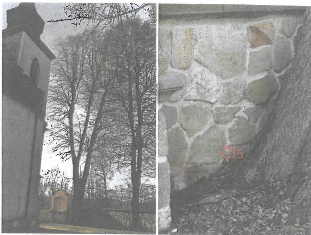
Fot.17-18. Drzewo nr 7 – mur kamienny w bezpośredniej strefie korzenienia się drzewa (5)
